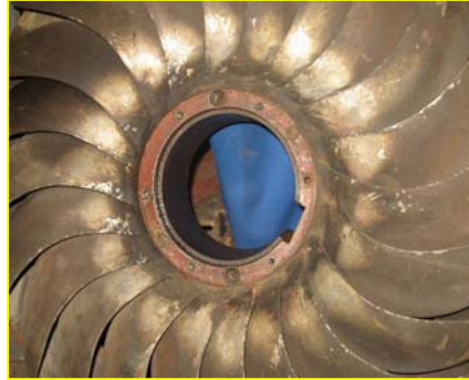
Hiện tượng chèn dòng phía sát bầu bánh công tác (BCT) của TBTN lắp đặt tại nhà máy thủy điện Suối Tân
